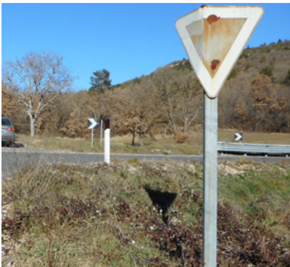
Assenza di manutenzione in violazione dell'articolo 14, comma 1, del Codice della Strada
