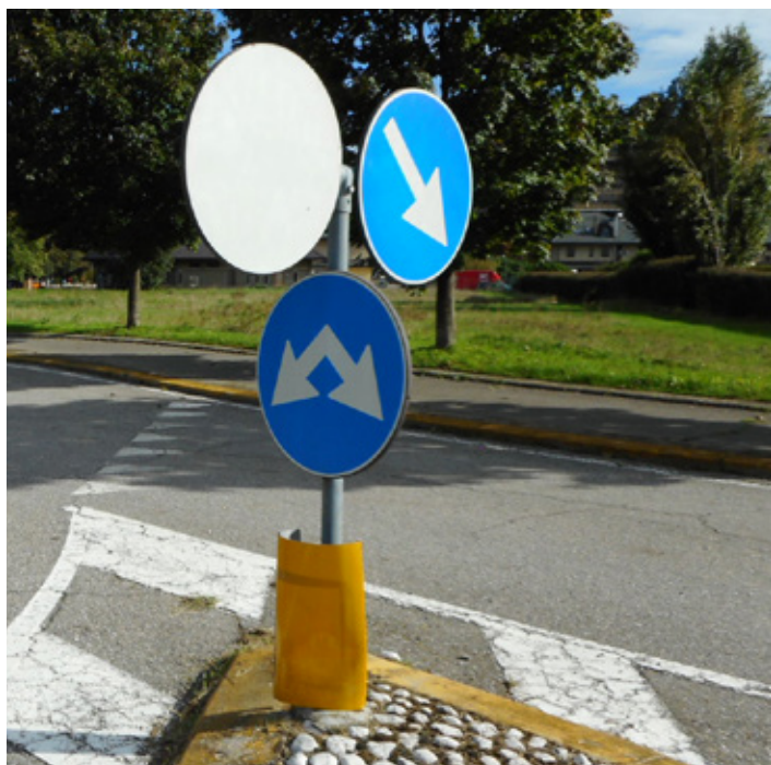
Assenza di manutenzione: segnaletica sbiadita, illeggibile e uso improprio del segnale fig. II 83, errato posizionamento
